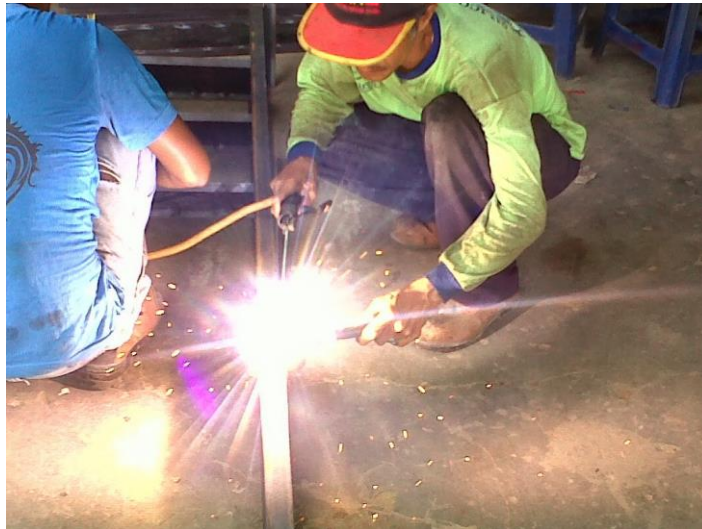
Gambar 13. Bekerja Tidak Menggunakan APD
