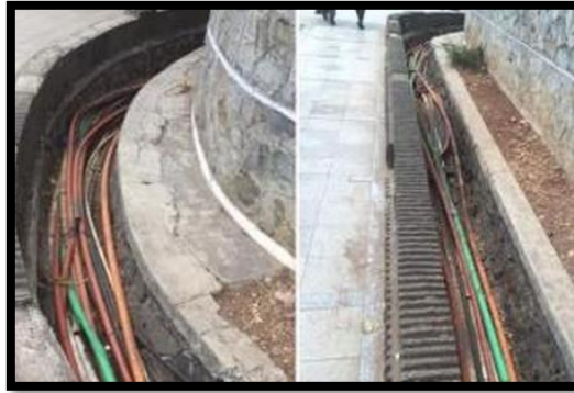
Gambar 9. 5 saluran kabel bawah tanah
