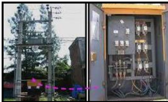
Gambar 10. 9 Gardu tiang jenis portal
